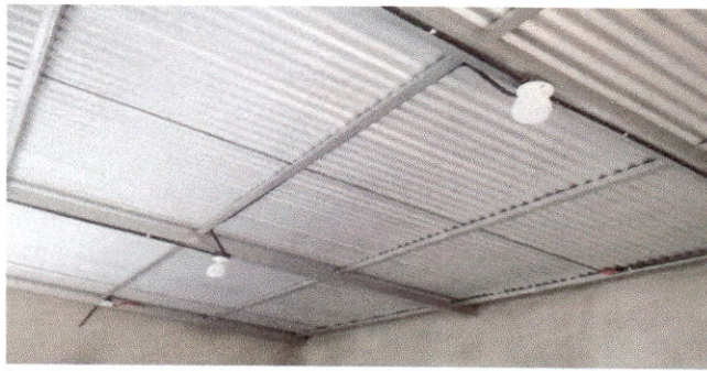
Foto 15: Reparación del sistema eléctrico: Instalación unidades de luz módulo 1 de aulas, cocina y salón.
