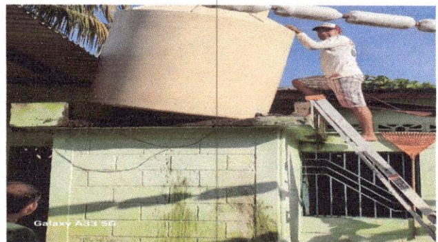
Foto 10 Reparación y mantenimiento de cisternas/ depósitos de agua: Sustitución de depósito de agua.
